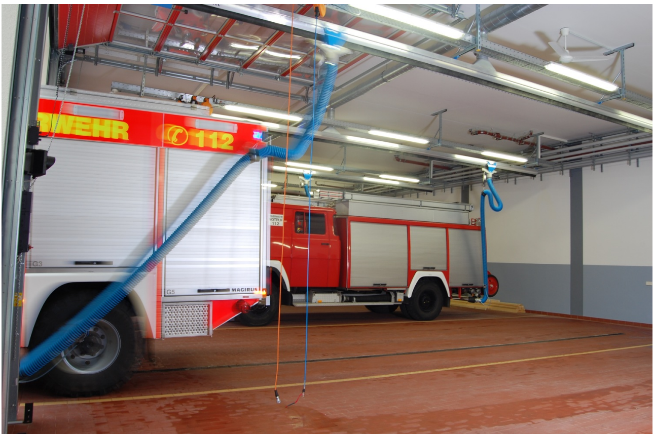
Abkopplung im Torbereich
